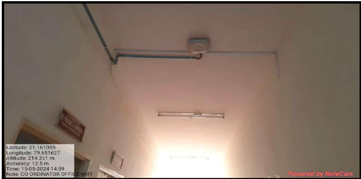
MBA CORRIDOR WIFI ROUTER - 22
