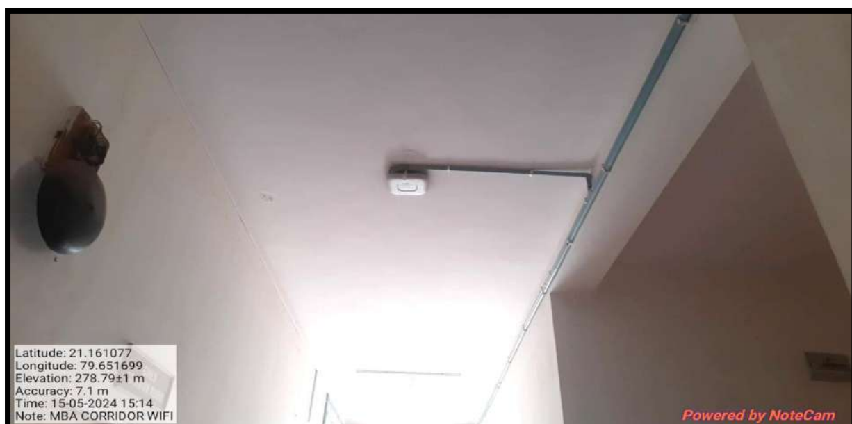
MBA CORRIDOR WIFI ROUTER - 21
